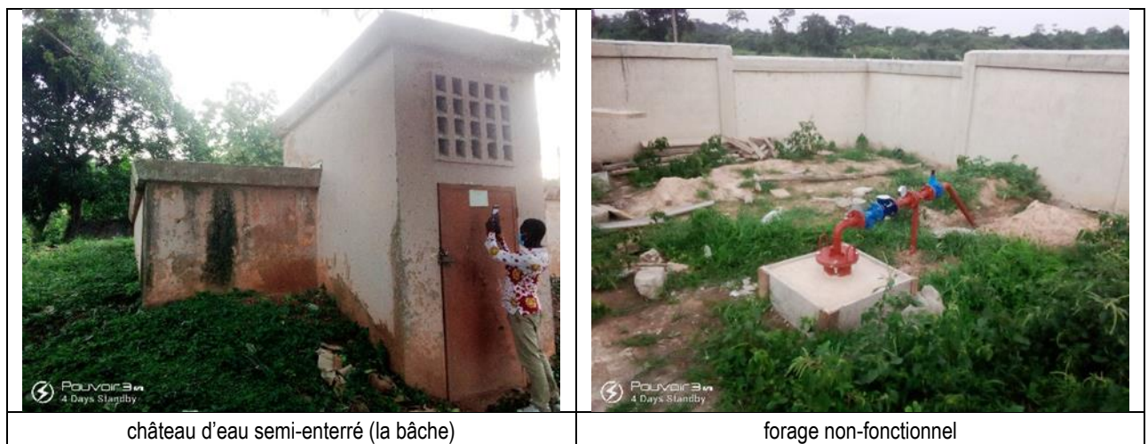
Planche 5 : Vue de certains ouvrages hydrauliques et sources d'approvisionnement en eau
