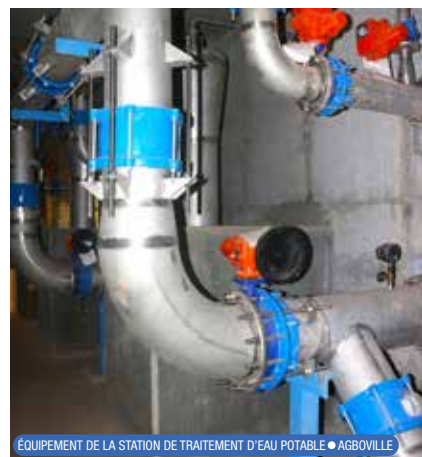
EQUIPEMENT DE LA STATION DE TRAITEMENT D'EAU POTABLE ● AGBOVILLE
